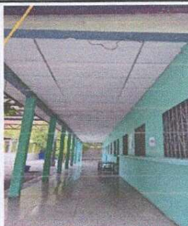
Foto 2: Sustrucción de cielo falso en mal estado en el corredor
