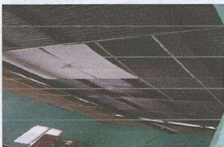
Foto 1: Sustrucción de cielo falso en mal estado aula 3.
